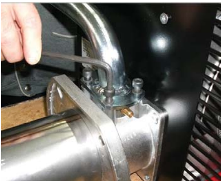
4) Прикрепить Труба ГАЗОВОЙ рампы в фланец при помощи 4-х винтов с цилиндрической головкой;
