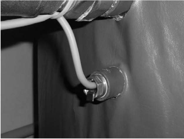
Рис. 13 – датчик температуры воды, установленный в отверстии расширительного бака (TV и TS)
